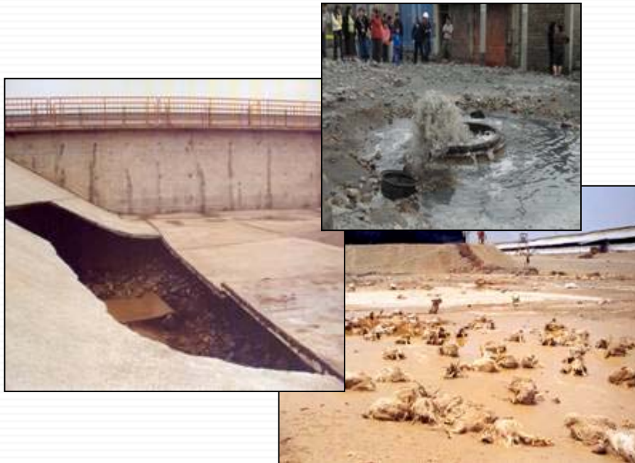
Planta de Tratamiento San Bartolo – Proyecto MESIAS SEDAPAL Costo: US$ 140 millones
