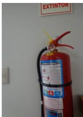
Extintor de polvo químico seco de 6kg sin carga vigente
