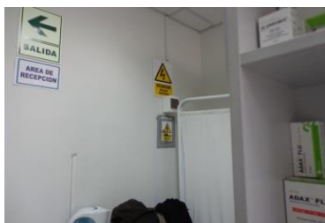
El tablero eléctrico es de metal
