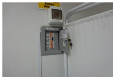
El tablero eléctrico tiene interruptores diferenciales
