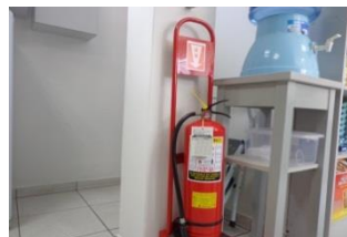
El extintor se encuentra en buen estado, operativo y con carga vigente
